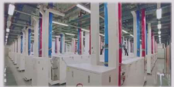
液冷机房内景（来源：阿里巴巴）
